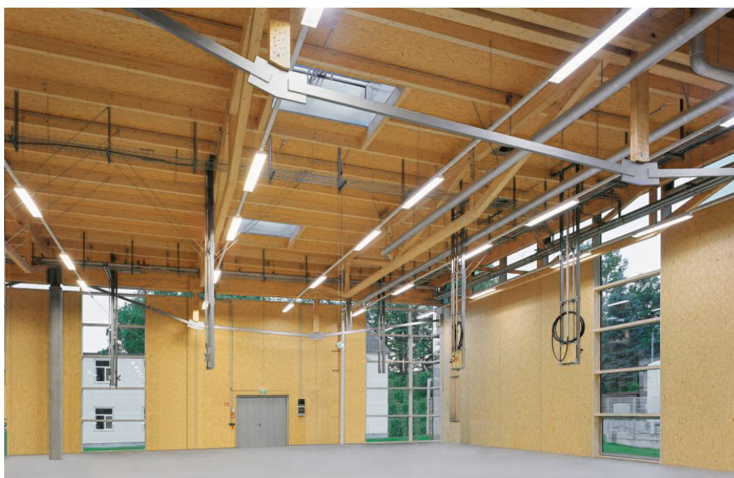
Abb. 4.7 Flachdachkonstruktion einer Produktionshalle (Firma Nirosoan Multifit in Schmiedefeld, Architekturbüro Dipl.-Ing. Michael Juhr, Wuppertal)
