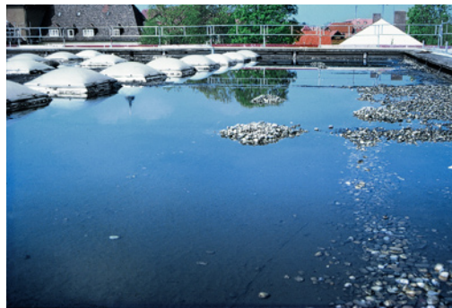
Abb. 3.1 Stehendes Wasser auf einem 0°-Dach
