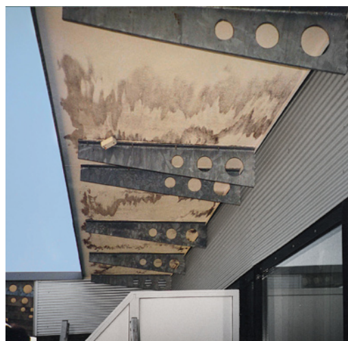
Abb. 7.2 Verfärbungen einer Dachunterseite aus BFU-Platten
